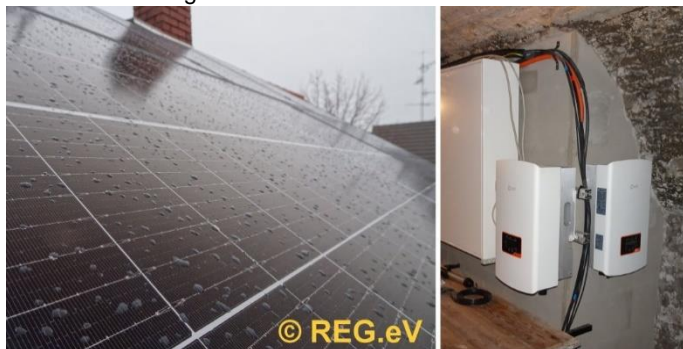
Bild: Links ein Ausschnitt aus den selbst montierten PV-Modulen und rechts Teil des neuen Zählerschranks mit der Ecklösung für zwei Wechselrichter im Kellergewölbe für zwei Dachteile
